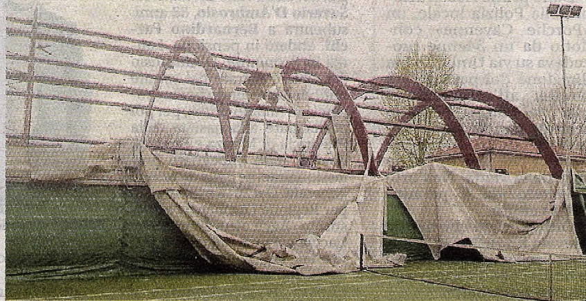
CENTRO SPORTIVO il campo da tennis completamente scoperchiato
